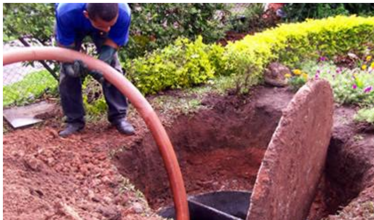
Figura 5 – Limpeza do sistema individual de tratamento do esgoto doméstico.
