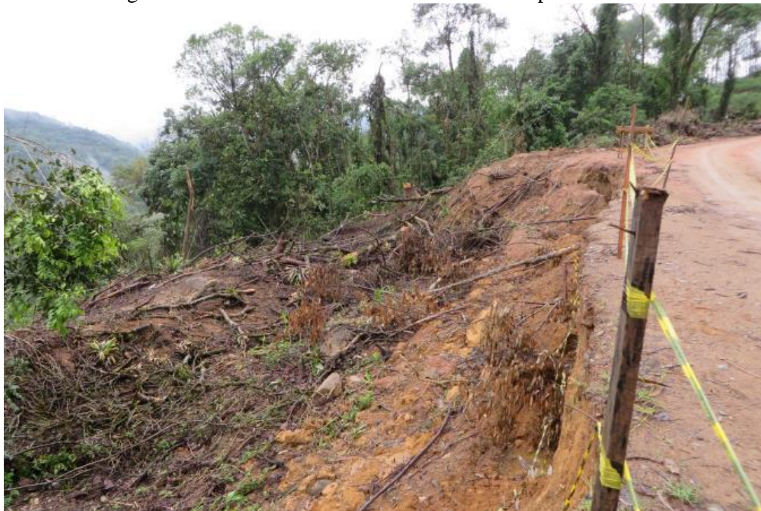
Figura 43 – Deslizamento no Setor 01 do município de Rio Dos Cedros
