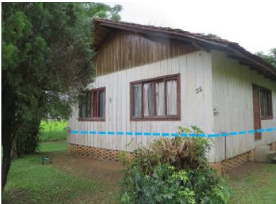
Figura 34 – Marca de inundação em residência
