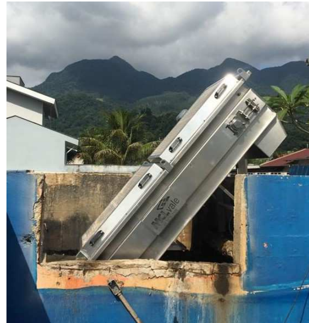
Gradeamento mecanizado para esgoto domestico - Estação Figueira
