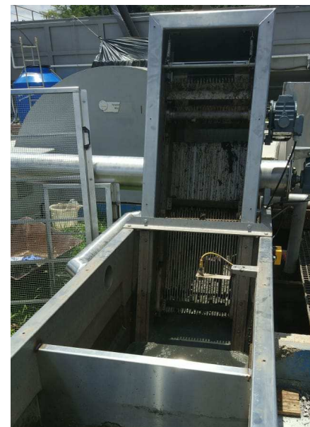
Skid tratamento preliminar 58m 3 /h – Estação Águas Verdes
