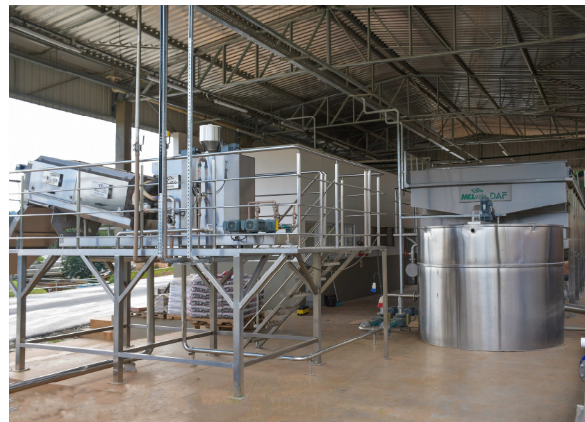
Sistema Integrado Megapress e Flotador DAF 3000
