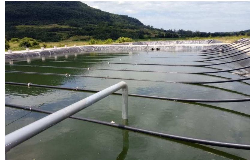
Sistema de aeração
