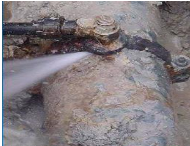
Vazamentos: fugas por excesso de pressão
