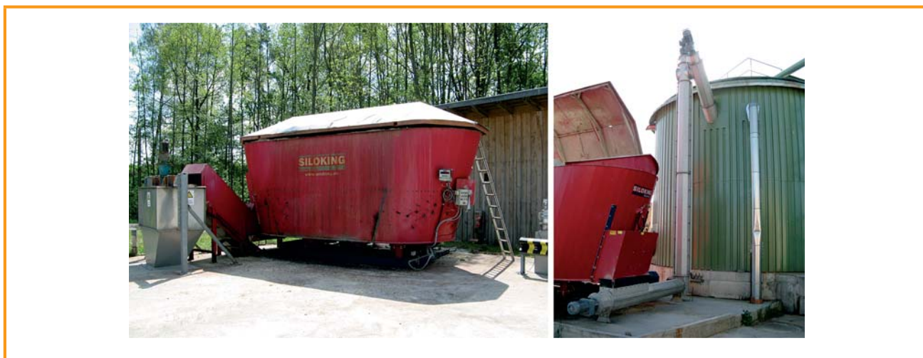
Figura 3.19: Carregamento de biomassa empilhável com transportador helicoidal [DBFZ]
