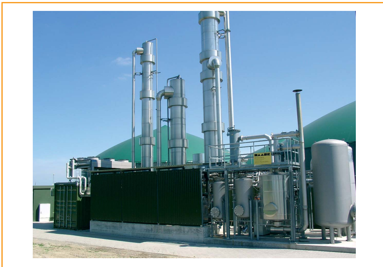
Figura 6.3: Estação de tratamento de biogás (lavagem Genosorb) em Ronnenberg [Urban, Fraunhofer UMSICHT]
