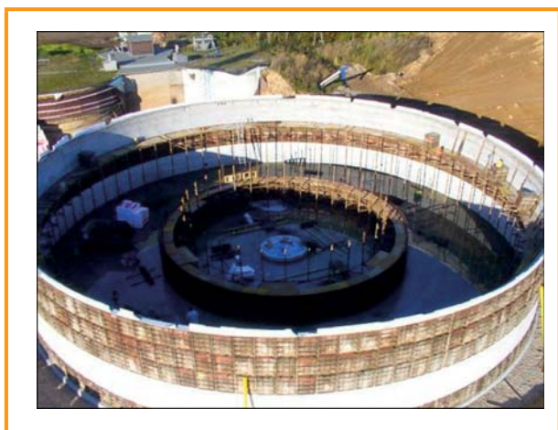
Figura 3.29: Construção de um biodigestor de concreto [Johann Wolf GmbH & Co Systembau KG]
