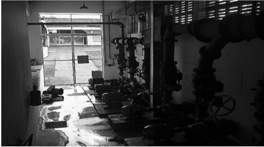
ILUSTRAÇÃO 3.5.2.13 – VAZAMENTO DE ÁGUA – MANUTENÇÃO DEFICIENTE
