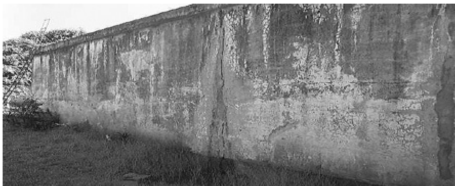
ILUSTRAÇÃO 3.5.2.22– RESERVATÓRIO SEM MANUTENÇÃO
