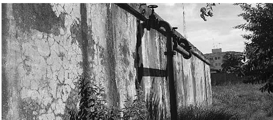
ILUSTRAÇÃO 3.5.2.23 – RESERVATÓRIO SEM MANUTENÇÃO
