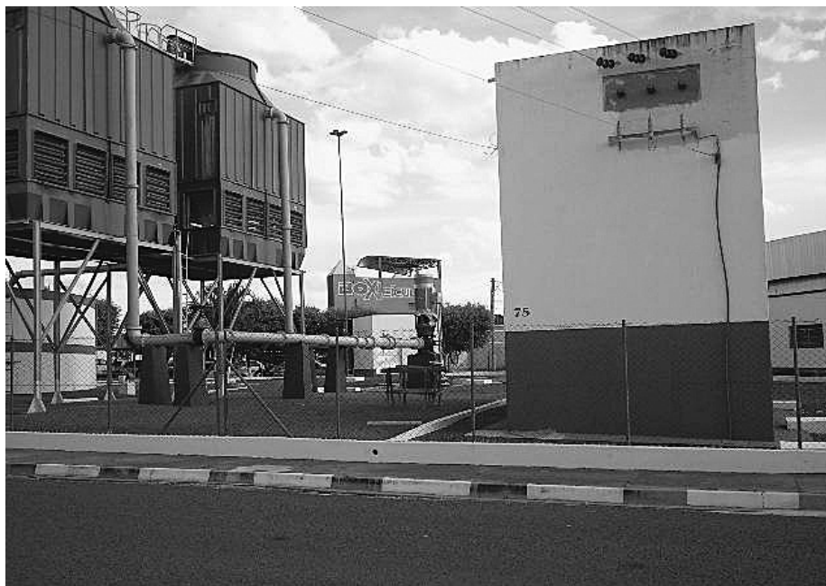
ILUSTRAÇÃO 3.5.2.16 – CAPTAÇÃO DE ÁGUA SUBTERRÂNEA COM TORRE DE RESFRIAMENTO
