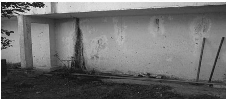
ILUSTRAÇÃO 3.5.2.17 – PAREDES DA ETA COM VAZAMENTOS
