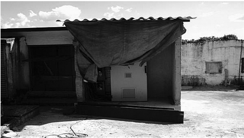
ILUSTRAÇÃO 3.5.2.15 – ESTAÇÃO ELEVATÓRIA IMPROVISADA – CABOS NO TERRENO
