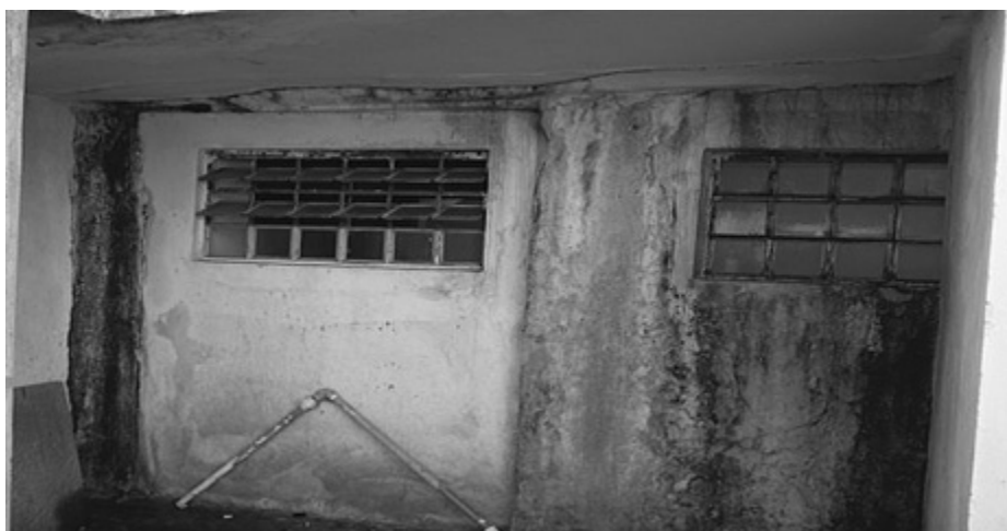
ILUSTRAÇÃO 3.5.2.18 – PAREDES DA ETA COM VAZAMENTOS
